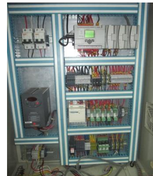
Foto 2.- Vista interior del tablero eléctrico principal del banco de pruebas con Variador de Frecuencias y PLC programable
